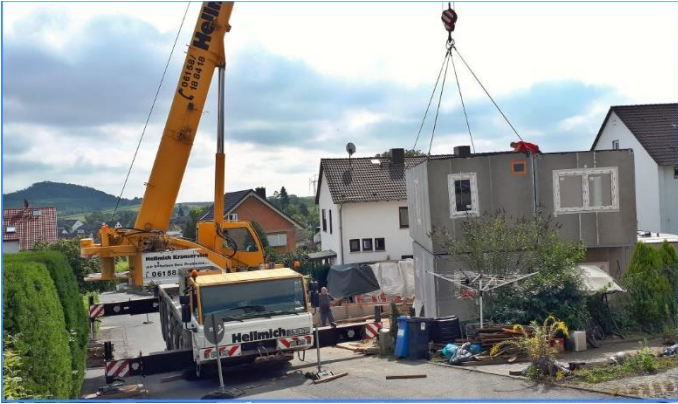
Bild: Das letzte der fünf Module für ein energieeffizientes Wohnhaus wird aufgesetzt, Foto: K. Pfeifer
